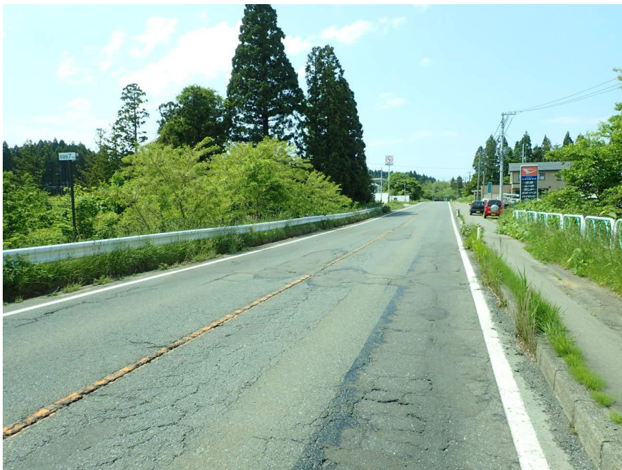
国道4号（亀甲状のひび割れとパッチング補修跡）
