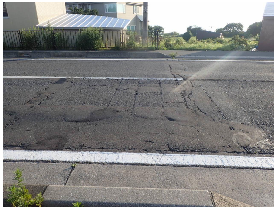
国道4号（横断ひび割れとパッチング補修跡）
